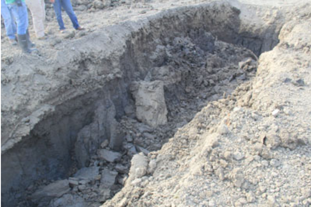
Figura 9 - Fotografia de trincheira após colapso
